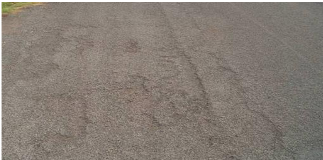
Figure 2.8: Raveling (Kamiti road)
